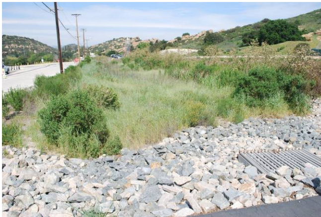
2015: B1436 Detention Bioswales
